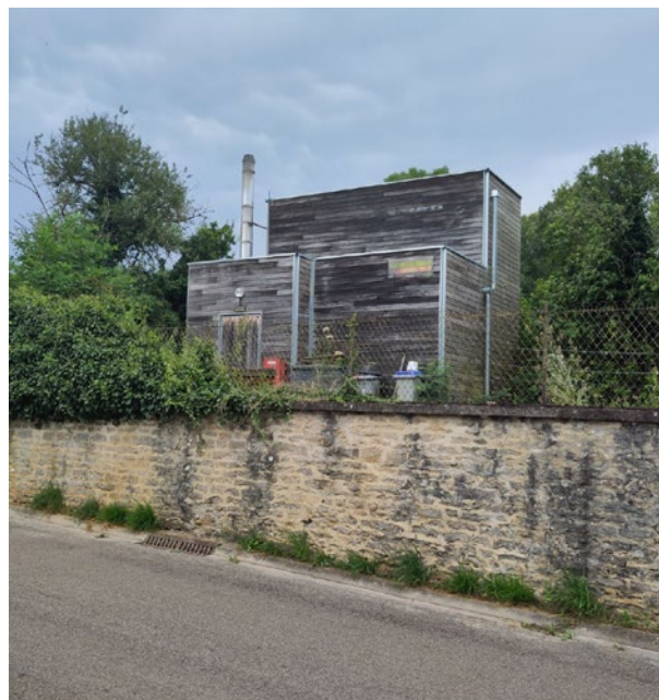
Une chaudière collective, bardée de bois à Courcelles-sur-Aujon (52) © Parc national de forêts
