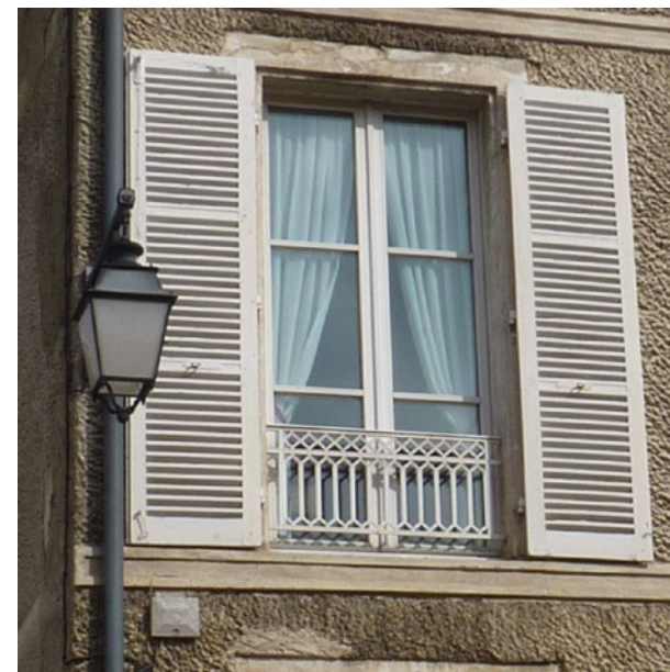
Un garde-corps à Arc-en-Barrois (52) © Parc national de forêts
