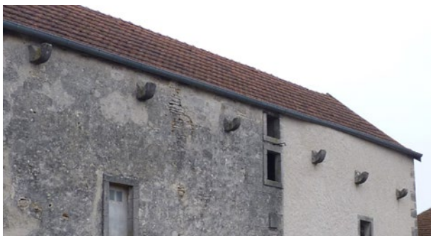
Les corbeaux de maintien d'une ancienne gouttière à Bugnières (52) © Parc national de forêts
