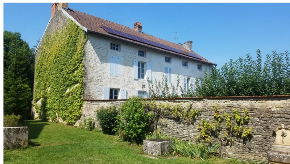
Des panneaux photovoltaïques à Montigny-sur-Aube (21), idéalement placés près de la base du toit © Parc national de forêts
